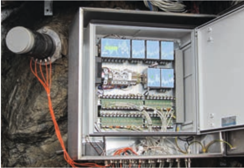
Bohrungen im Gipfelbereich der Grawand. Nordende des Bohrloches mit den Kabeln der Temperatursonden zur Stromversorgung, Steuerungs- und Speichereinheit.
