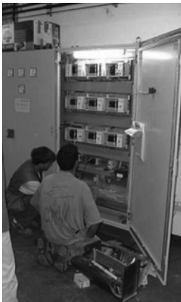
Bild 1.9 Klemmleiste und DDC-Bausteine im Schaltschrank [ABB]
