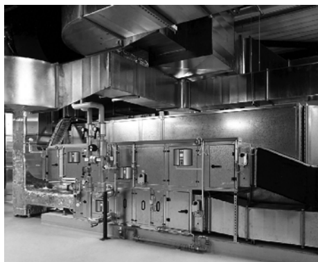
Bild 1.1 Lüftungsanlage in einem Zweckbau [ABB]
