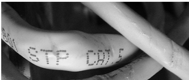
Abbildung 3.9: Diese verlegten TP-Kabel sind zu stark geknickt und beschädigt, als dass man mit ihnen noch zuverlässige Verbindungen erhalten könnte.
