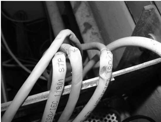
Abbildung 3.17: Der Blick in den Kabelschacht lässt hier die Probleme im LAN erkennen.
