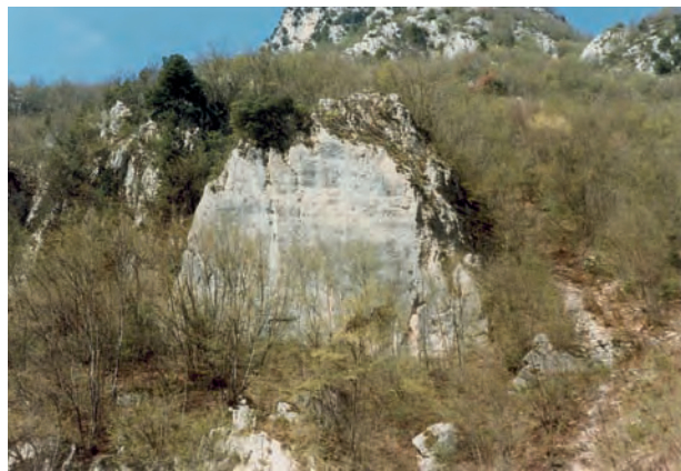
Abb. 5 Großflächige Abarbeitungen hoher Felswände über der Straße erforderten, da Wasser und Vegetation in den Felsspalten arbeiteten, regelmäßige Inspektion. Wo keine Straßenaufsicht mehr eingriff, konnte niedergehendes Gestein in engem Tal die Straße bald blockieren und aus ihrer kühnen geraden Bahn drängen. Via Salaria, Gole del Velino: Masso dell’Orso , fast 20 m hohe Abarbeitung, unten links eingetieftes Feld für eine (verlorene) Inschrift.
