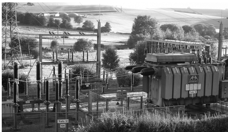
Bild 3 110 kV Freiluft-Schaltanlage und Umspannwerk (Quelle: Thomas Schichel).
