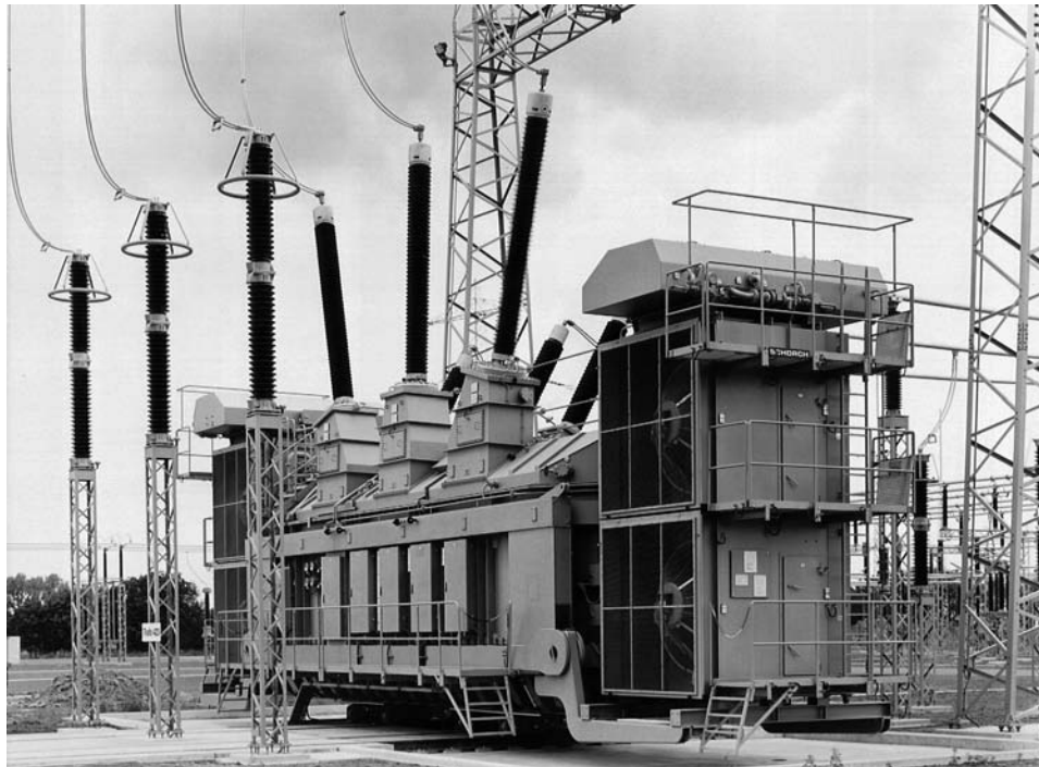
Bild 1.8.17 Netzkoppeltransformator mit der Kühlungsart OFAF (Werkbild Areva)
