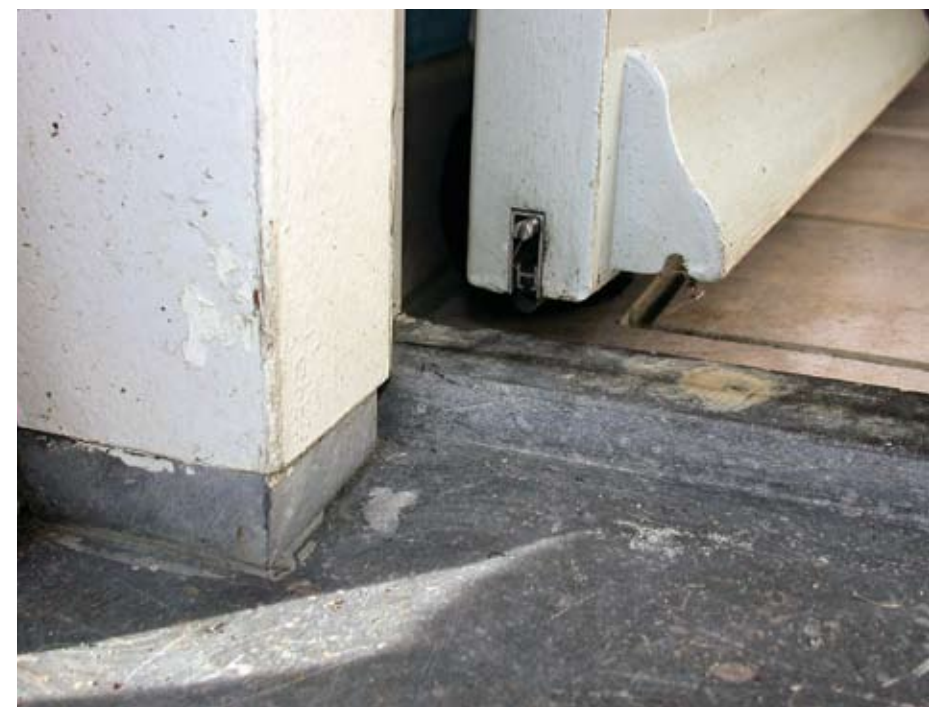
Haustüren ohne Stufenfalz in der Laibung können zu Luftdichtheitsproblemen führen
