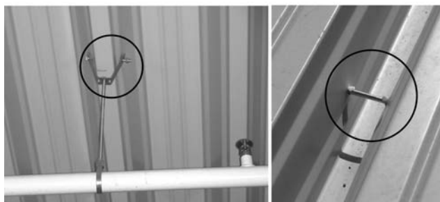
Bild 5-6 Abhängung von Zusatzlasten an Stahltrapezprofilen – unten links: Blick von unten, unten rechts: Blick von oben
