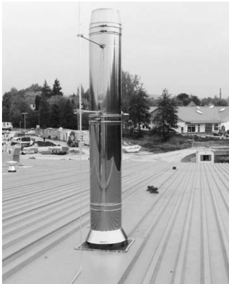
Bild 5-36 Dichtmanschette auf Schleppblech an einer Rohrdurchführung
